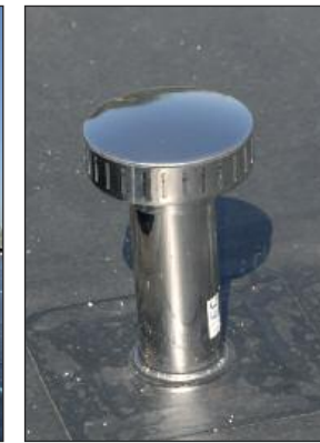
Freie Bahn für die Abluft: Edelstahl-Lüfterelement.
